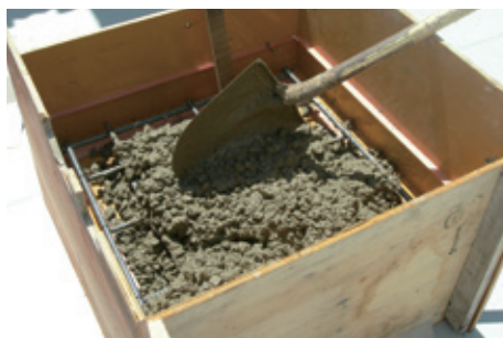
小規模工事の小型構造物では機械を用いた締め固めが面倒
