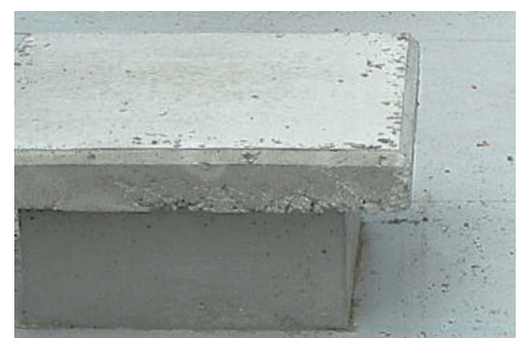
手直しが発生しやすい。更に頭部へアンカーボルト穴の穿孔が必要
