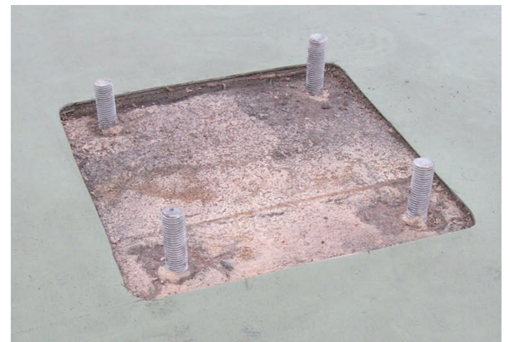
既存防水層を撤去し、保護コンクリート又はスラブを露出させ、アンカーボルトを取付ける。
