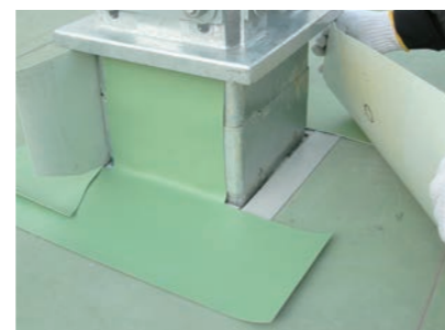
⑦操作窓を閉じて、防水層を設置(④の次に実施してもよい)
