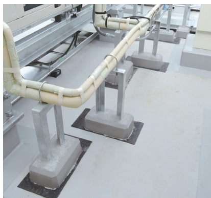
固定されていない重い置き基礎は、地震時に揺れると、かえって配管類の被害を拡大させる
