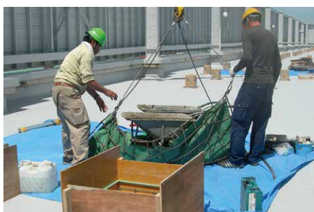
小規模工事ではコンクリートの揚重が大変(既存建物での施工例)
