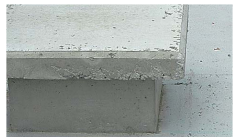
手直しが発生しやすい。更に頭部へアンカーボルト穴の穿孔が必要
